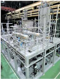
マレーシアでの実証実験に使用される予定の海洋温度差発電プラント
